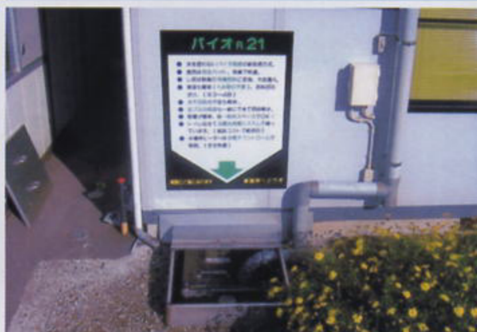
本社事務所トイレ（お試し頂けます）
